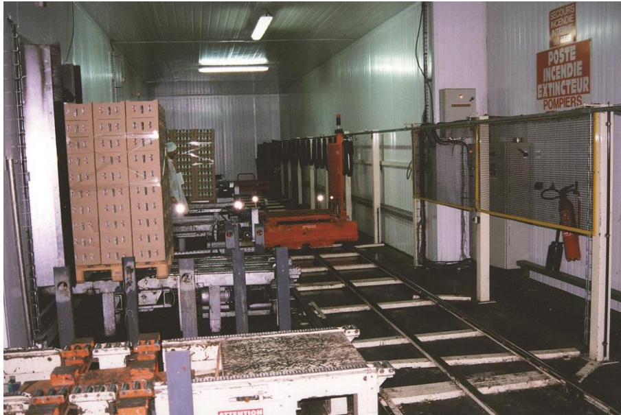
Navette installée en 1993 en sortie des tunnels de refroidissement
